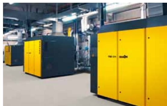
Светлая и просторная компрессорная станция на новом заводе «nkt cables»
